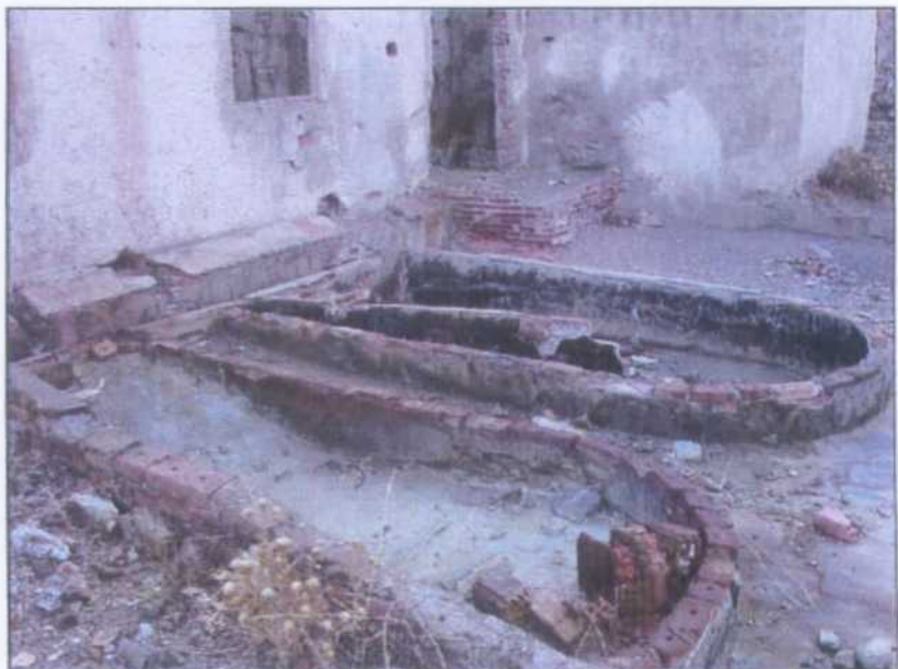
LP004.- Balsas de decantación de lodos del lavadero.
