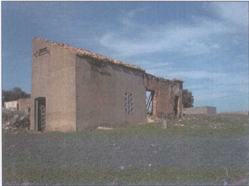
DG025.- Caseta del transformador eléctrico del pozo nº 4.
