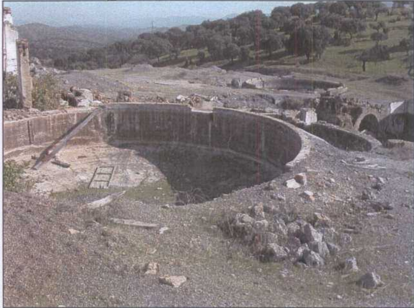
DG022.- Tanques espesadores de pulpa de concentrados.
