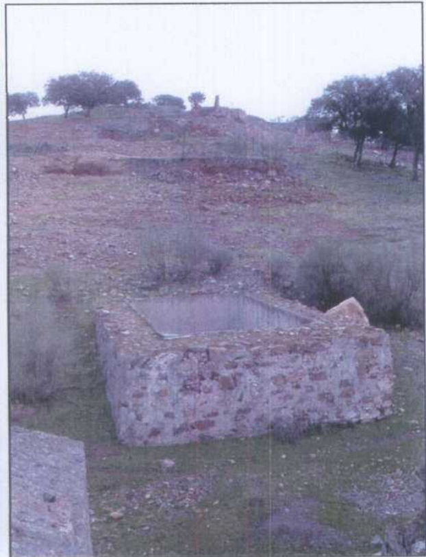
GJ004.- Depósito de recogida de agua del bombeo de la mina.
