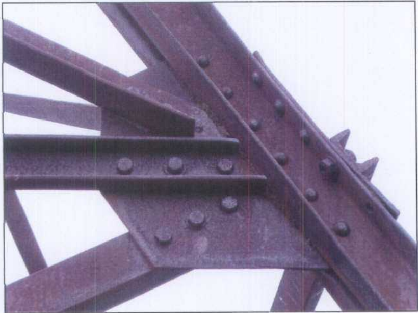
RB001.- Castillete metálico del pozo. Placa de unión a un pie delantero central con tornillería y remaches.
