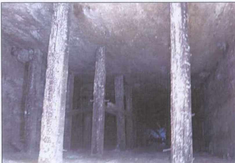
RM010.- Caña del pozo San Lorenzo. Conserva buena parte de las armaduras de madera del guionaje.
