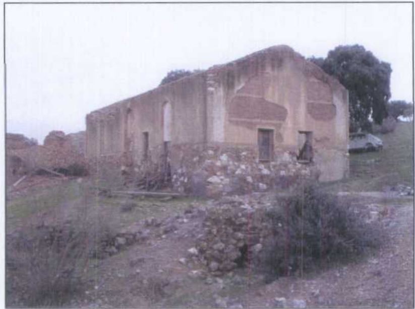
PZ003.- Casa de máquinas del pozo Maestro. Vista lateral y trasera.
