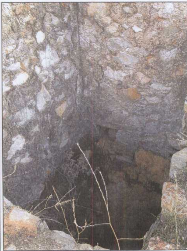
GT006.- Chimenea de ventilación situada cerca de la casa de máquinas del pozo Maestro.
