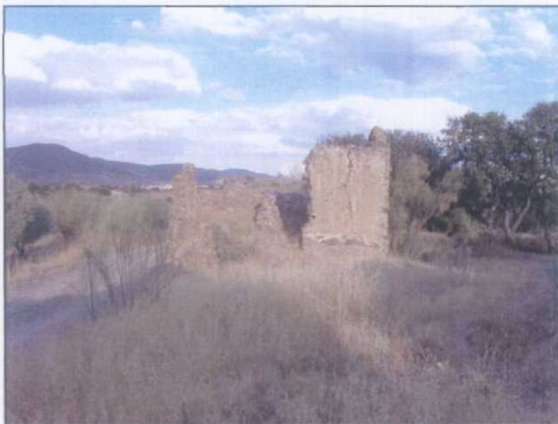
LJ003.- Vista trasera de la casa de máquinas del pozo Esperanza.
