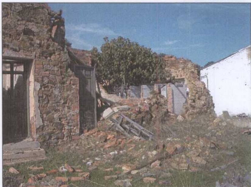
DG018.- Ruinas de edificios auxiliares..
