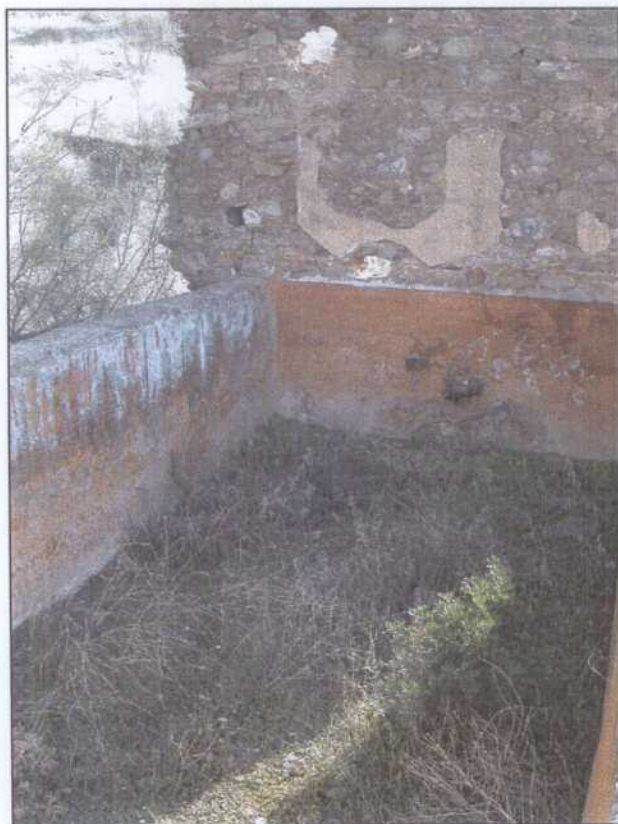
GT005.- Depósito interior de recogida del agua del bombeo. Este depósito se encuentra dentro del recinto de la casa de máquinas.
