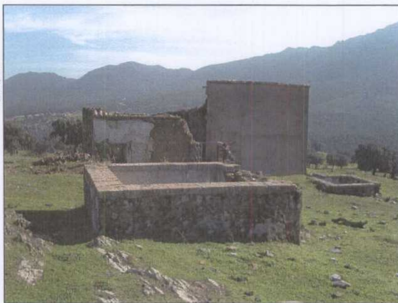
DG025.- Casa de máquinas del pozo nº 4. Por delante aparece un pequeño depósito de recogida de agua de bombeo.
