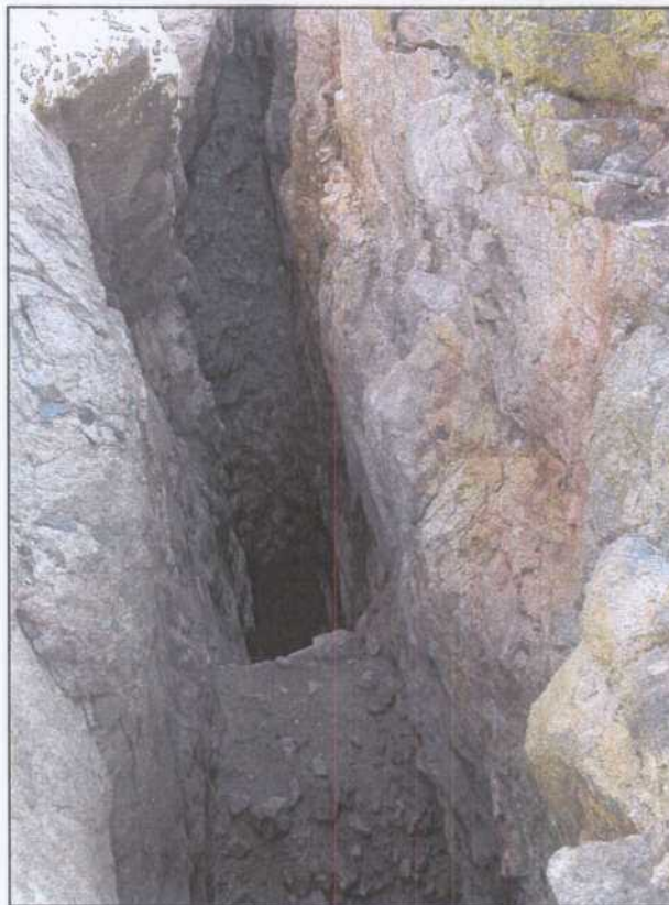
VE005.- Labor de explotación por realce parcialmente rellena. Vista de detalle.
