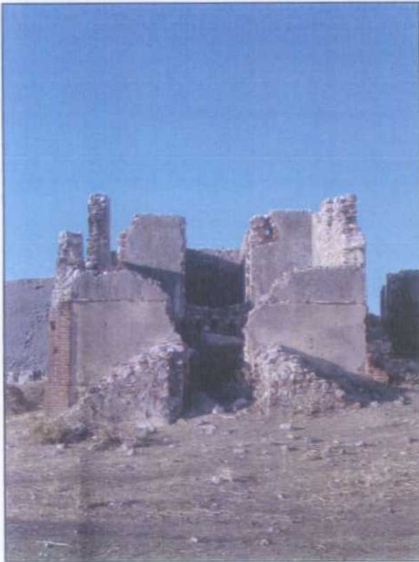
EM002.- Casa de máquinas del pozo San José. Vista trasera.
