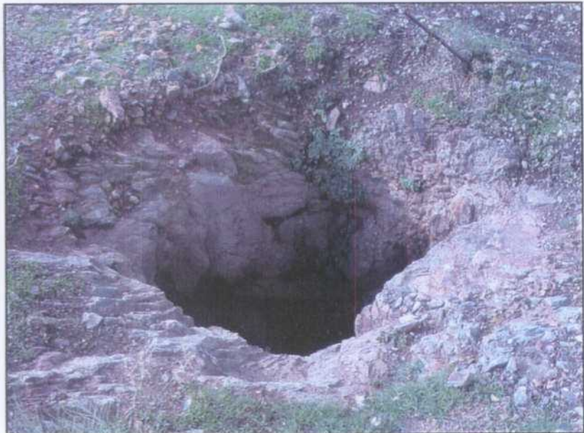
GJ007.- Chimenea de ventilación.
